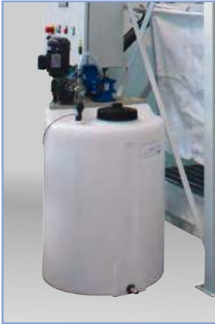
Stazione di preparazione dosaggio flocculante Station for flocculants dosage preparation Estación de preparación de dosis de flocculante Station de préparation du dosage agent flocculant
